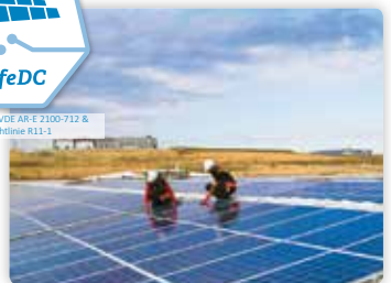
DC-Sicherheit schützt Installateure vor hoher DC-Spannung
